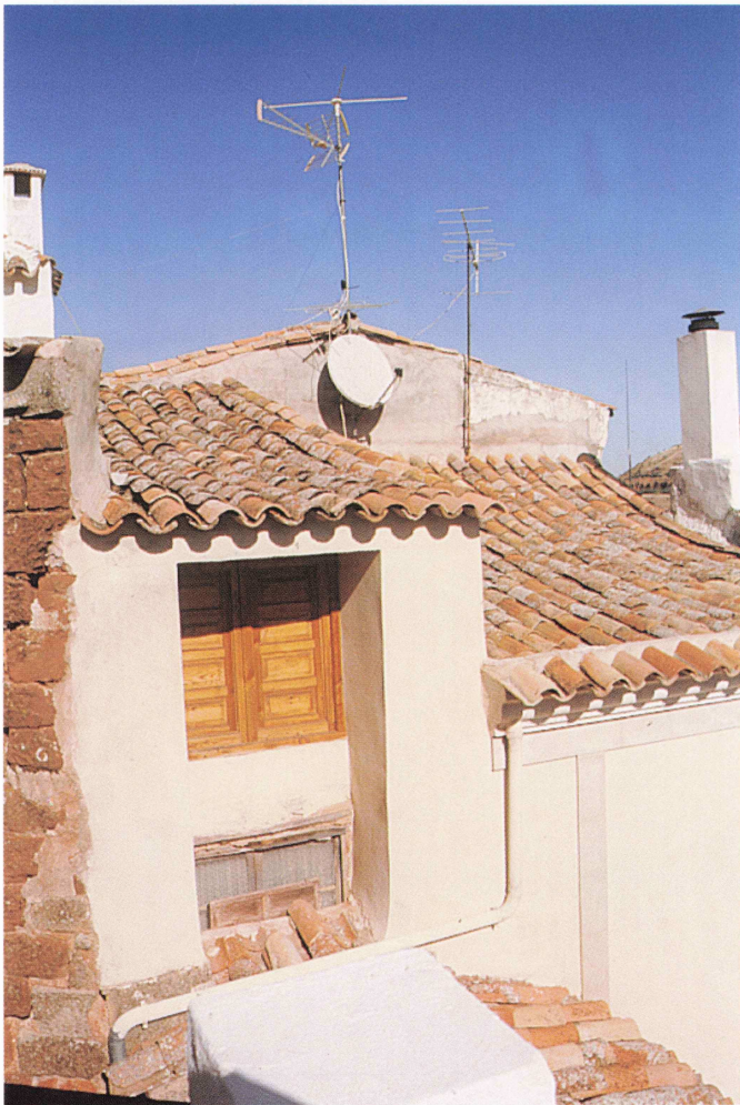
Fot. 29.- La puerta de conexión del Arco de la Zapatería con la fachada de la iglesia del convento a la Plaza Mayor se encuentra tapiada. Su vano se alargó para abrir la ventana que se ve por encima del tejadillo del arco y que ilumina una habitación de la casa de arriba.
