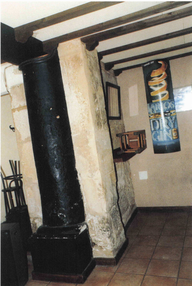
Fot. 7.- Lado del evangelio. Mitad inferior de la semicolumna del primer-segundo tramos y zona inferior de la segunda capilla.
