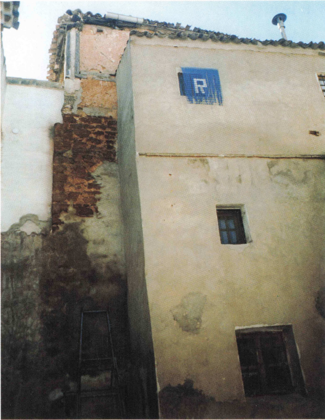
Fot. 5.- Cabecera de la antigua iglesia y muro lateral de la primera capilla del lado de la epístola. La parte alta del presbiterio es un añadido efectuado tras la enajenación del inmueble a particulares.
